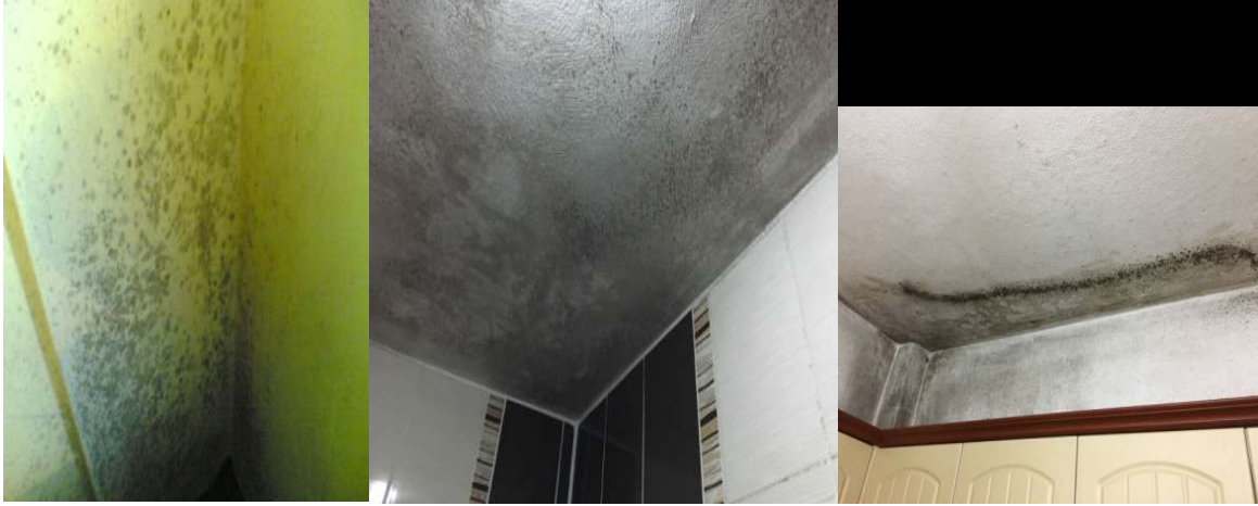
Şekil.1. Kiriş ve Döşeme Yapı Elemanlarında Çiçeklenme Görüntüleri
