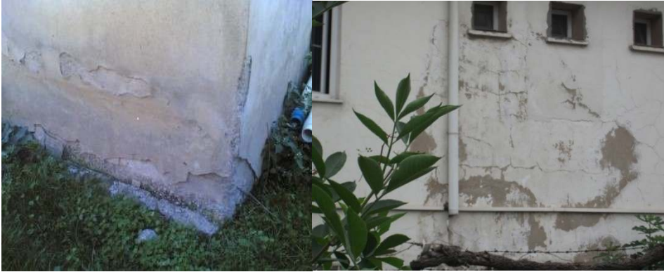
Şekil 3. Bina Dışında Oluşan Kabarma ve Dökülmeler
