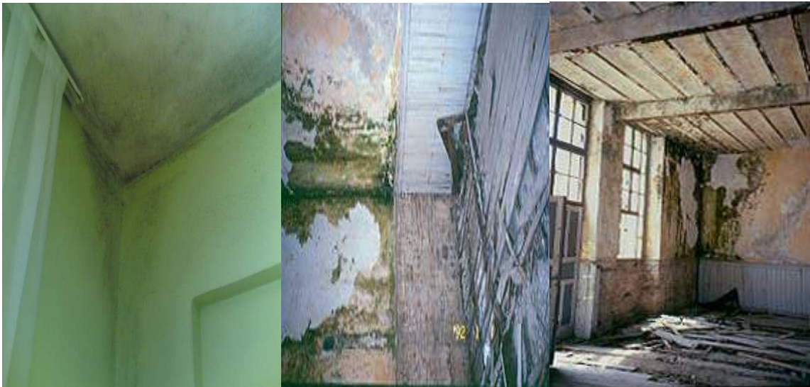
Şekil 2. Yapı İç Duvarlarındaki ve Döşemelerdeki Çiçeklenme Bozulmaları
